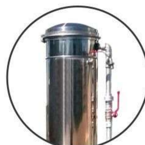
No Filtro de Água Central
