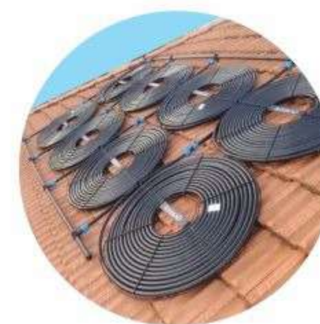
No Aquecedor Solar de Piscina
